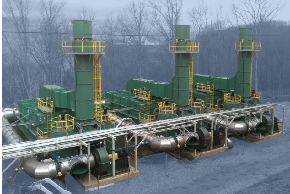
Figure 6.5 Installation Dürr de traitement du MAV (trois épurateurs) à la mine McElroy aux États-Unis
