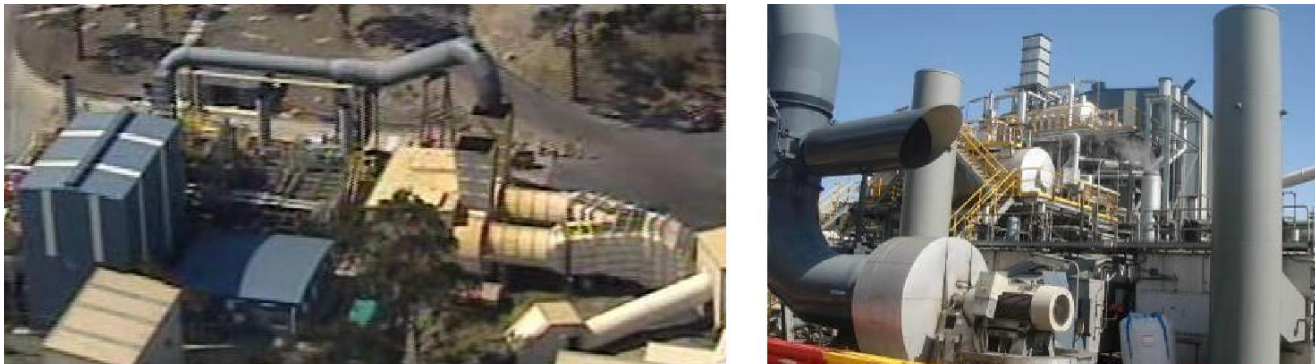
Figure 9.10 Traitement du MAV et centrale électrique WestVAMP
