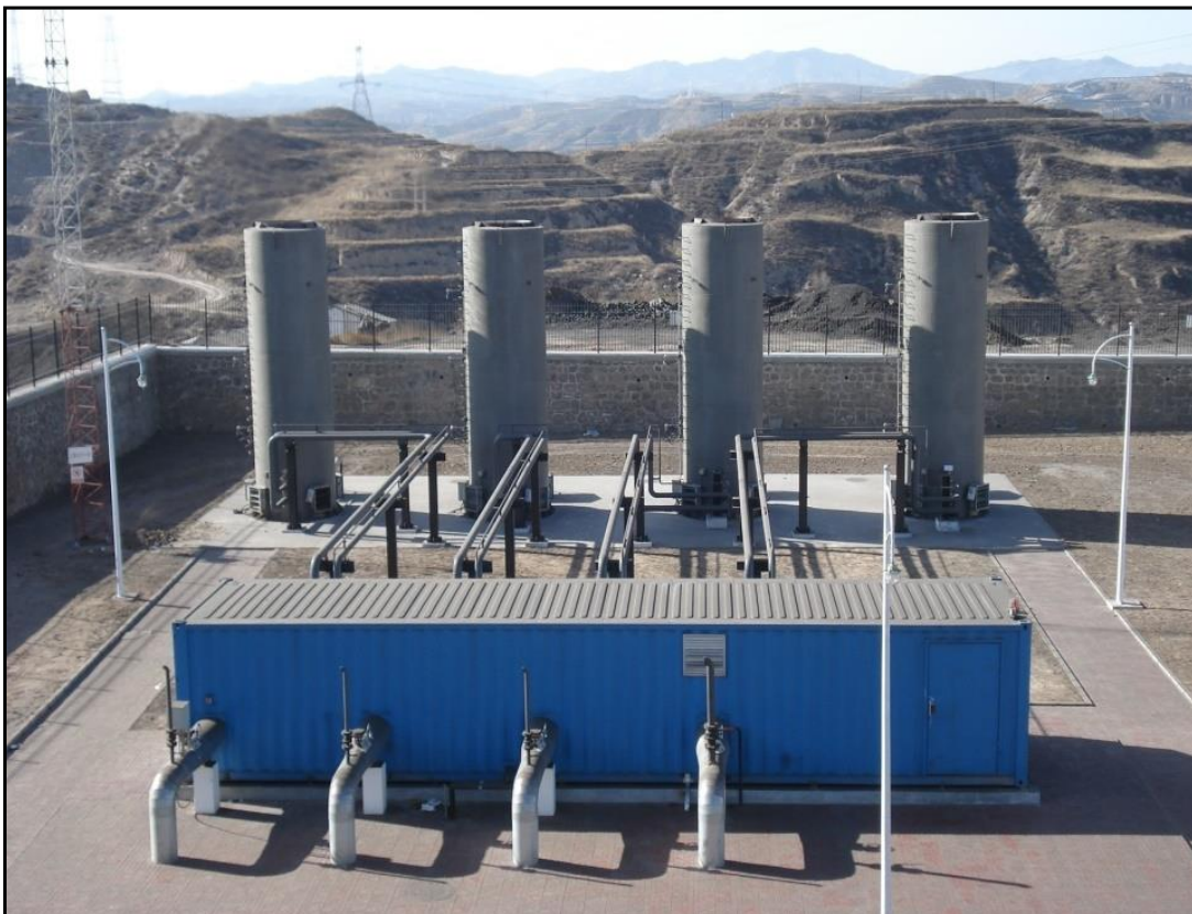
Figure 9.7 Système de torchères à la mine T
