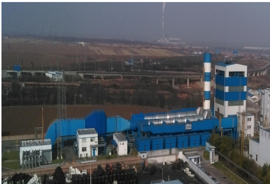
Figure 6.6 Installation de traitement du MAV de Dürr systems à la mine de Gaohe, Chine
