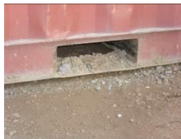
Figure 6.3 - Boue dans un passage de fourches
